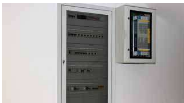
Esempio di protezione di un quadro CED già esistente di medie dimensioni con scaricatori ILF 4P 250
