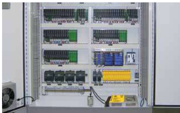
Esempio di protezione di circuiti di segnale e di un alimentatore con scaricatori ILF 2P 32 e S-ASI 24
