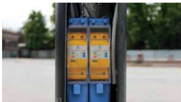
Esempio di protezione in morsettiera da palo per illuminazione pubblica a LED
