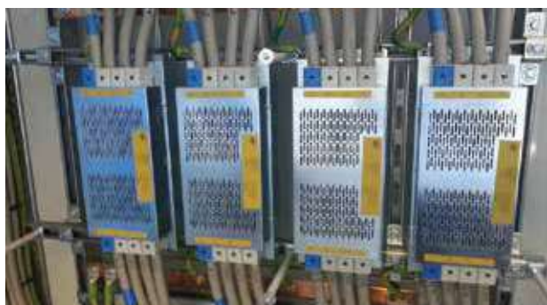
Esempio di protezione di un quadro CED già esistente di grandi dimensioni con scaricatori ILF 4P 400
