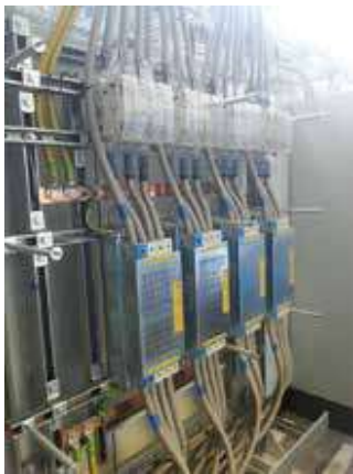
Datenzentrum ausgestattet mit 4 parallel angeordneten ILF 4P 400 SPDs.
